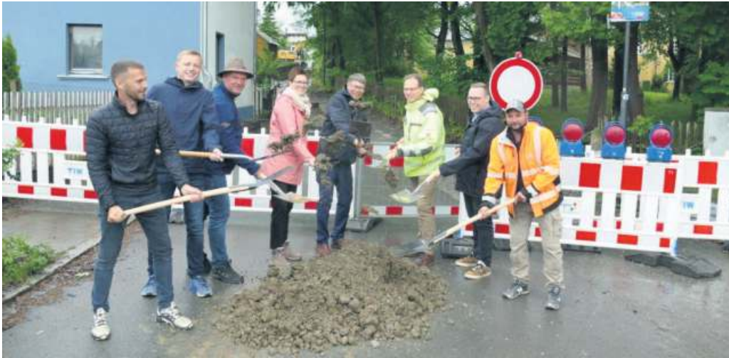
Start der Dorferneuerung im Berger Ortsteil Gottsmannsgrün. Im Gutshofweg haben die Bauarbeiten begonnen. Symbolischer Spatenstich (von links) Geschäftsführer der Baufirma Woldemar Buchmüller, Gottsmannsgrüner Gemeinderat Sebastian Kant, Bauleiter vom Planungsbüro USS Consult Naila, Frank Lailach, Bürgermeisterin Patricia Rubner, Abteilungsleiter vom ALE Joachim Block und Mitarbeiter Thomas Pfeuffer, Verwaltungsleiter Felix Korn und Polier der Baufirma Benjamin Ehrhardt.
