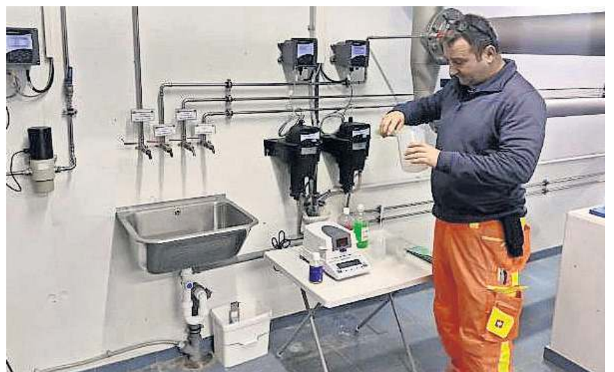
Prüfen von Trinkwasserparametern in der Trinkwasseraufbereitungsanlage Naila.
